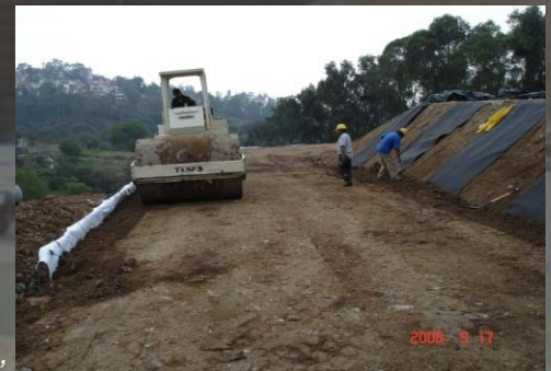
Relleno y compactación. Se observa dren prefabricado interceptor de flujos de la ladera
