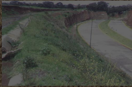
2. Resultados al cabo de 18 meses: se ha desarrollado una amplia cobertura vegetal. Se nota erosión del predio vecino, no protegido
