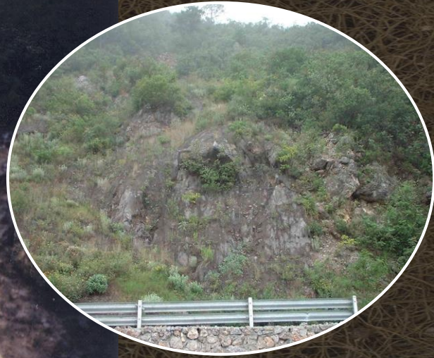
Año 2003: cuatro años después, el talud se revegetó a pesar de no haberse implantado semilla y la roca de gran tamaño que amenazaba con caer, continúa estabilizada.
